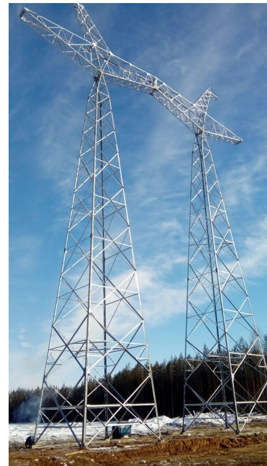
ВЛ 750 кВ «Ленинградская- Белозерская», металлические опоры
