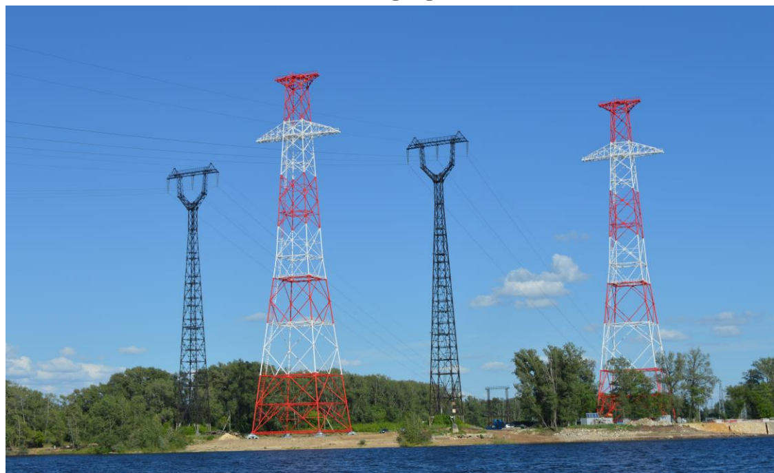
Спецпереход ВЛ 220 кВ «Балаково 1, 2» через р. Волга, переходные металлические трубные опоры: АТ-96, АТ-87
